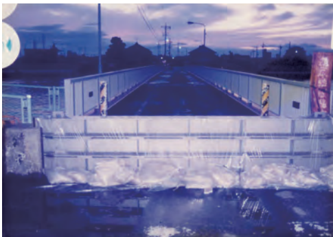
増水の際に、砂子橋に設置した止水板（平成6年）
