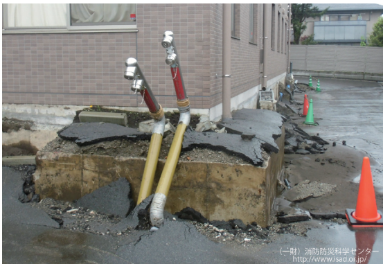
液状化による埋設管の被害 (出典：災害写真データベース)
