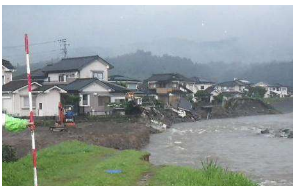
河岸侵食による家屋の倒壊(花月川)
