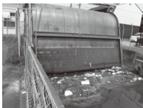
排水機場に流れ着いた ごみの状況
