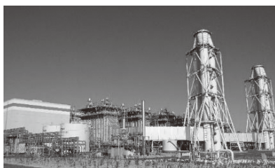
◀西名古屋 火力発電所
