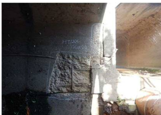
写真：剥離・鉄筋露出
