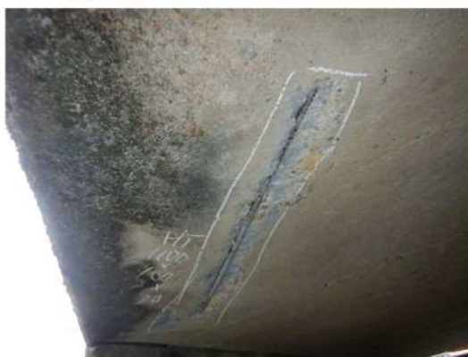
写真：剥離・鉄筋露出
