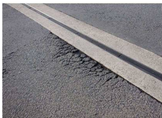
写真：舗装ひびわれ、路面の凹凸
